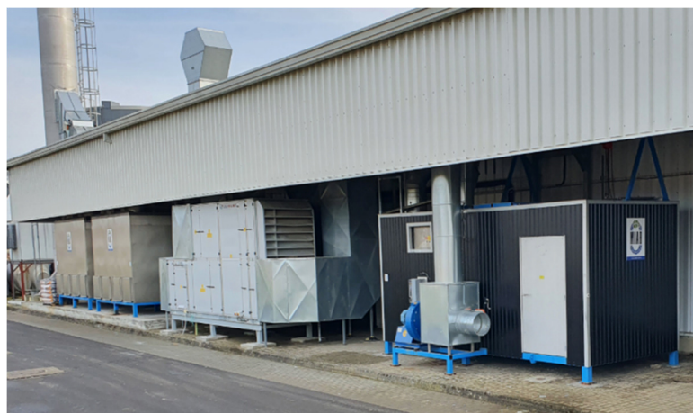
Bild 1. MIAB FD-anläggning med två filter, se rostfria enheter till vänster, samt katalysator, se svart enhet med dörr till höger.
