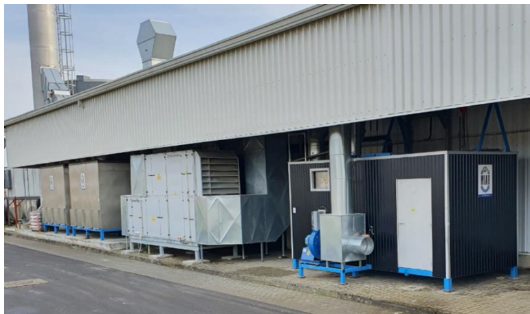
Bild 1. MIAB FD-anläggning med två filter, se rostfria enheter till vänster, samt katalysator, se svart enhet med dörr till höger.
